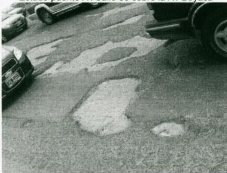
Foto N° 4 y 5 Estado puente AV Calle 80 sobre la Av Boyacá
